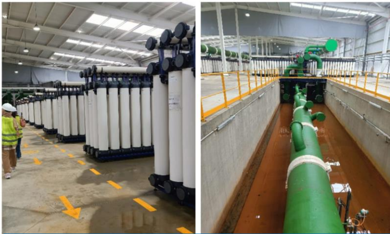
خلال تفقد وحدات محطة تصفية مياه البحر بسهل اشتوكة
